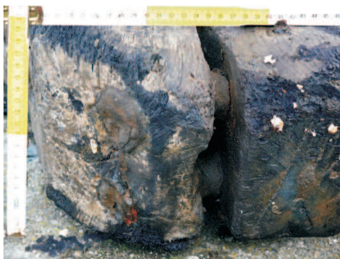
Ryc. 7. Widok na łączenie węzłówki z belką stępki, fot. A. Ostasz
